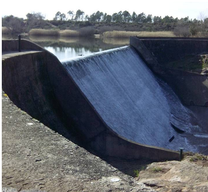
Barrage en situation de débordement
